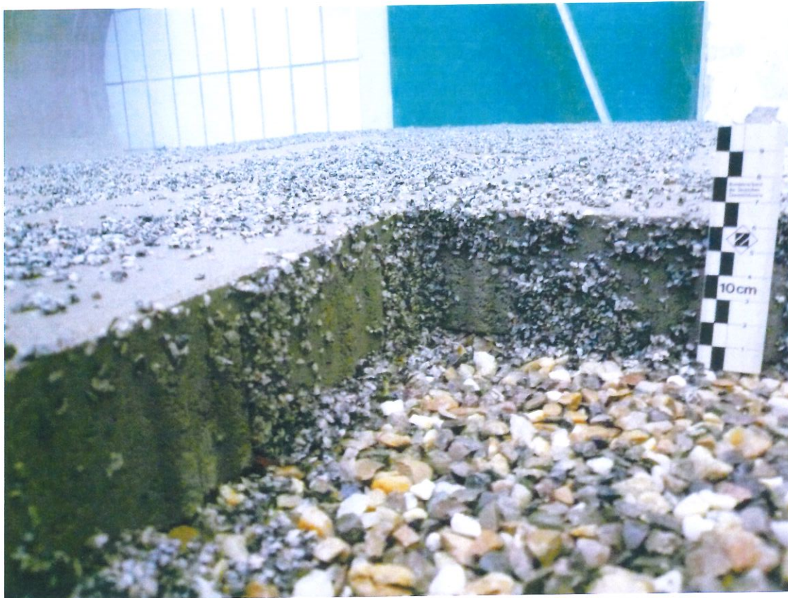
Bild 5: Detailansicht, Fuge nach Bewässerung
