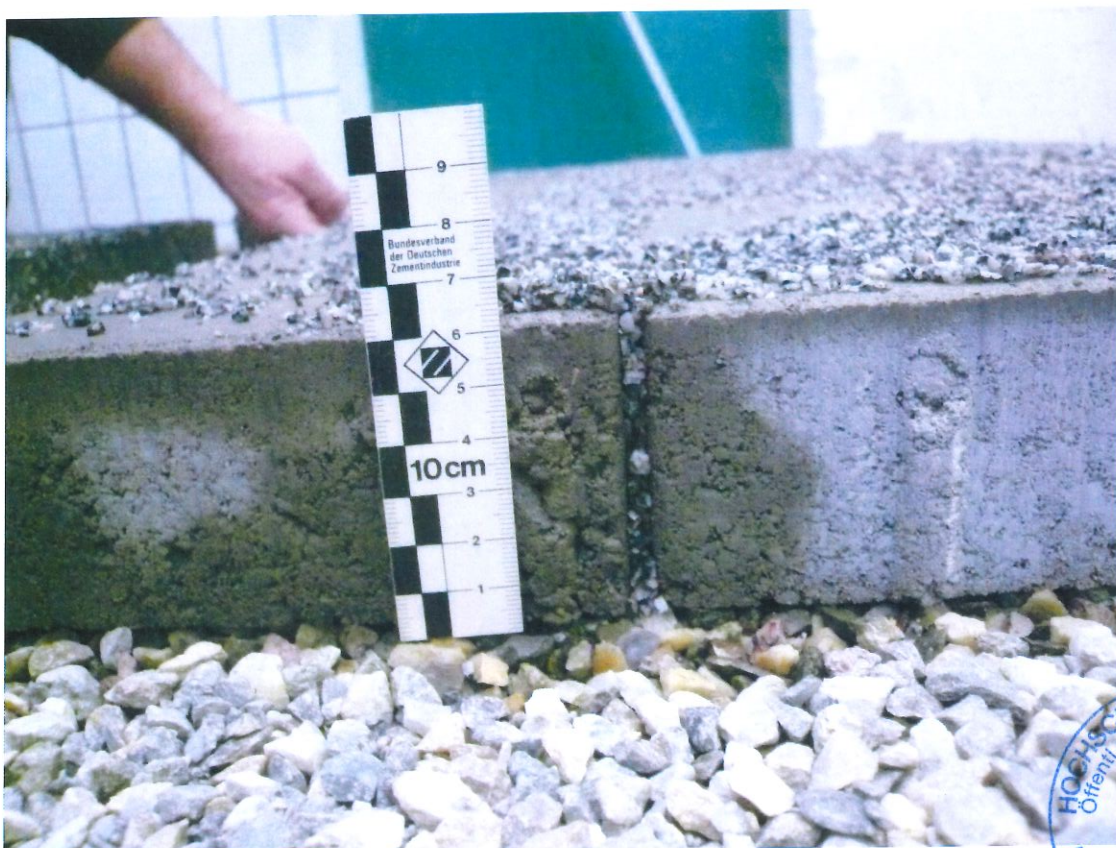
Bild 6: Detailansicht, Fuge nach Bewässerung
